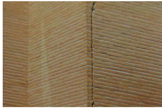
(d) Cracks due to moisture expansion
